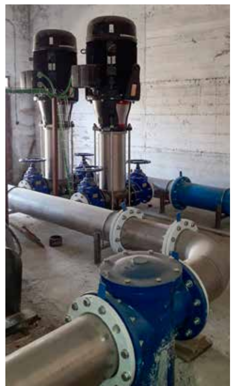
Duas bombas CRN da Grundfos asseguram um abastecimento de água fiável a milhares de pessoas.
