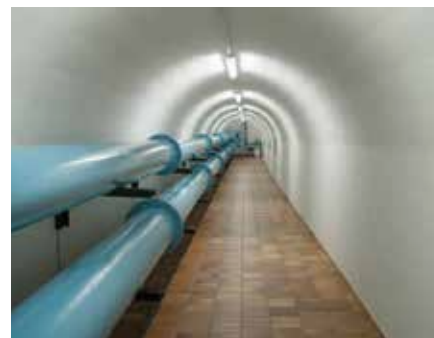
«Cavern 2» – um dos depósitos elevados. A tubagem apoia as duas células de armazenamento de 3000 m 3 que alimentam água para o sistema de abastecimento da cidade.
