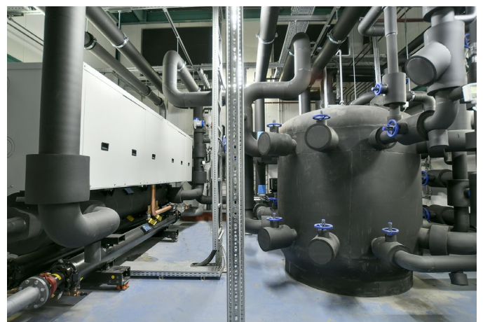
Unitate de răcire și unul dintre cele trei distribuitoare Zortström instalate
