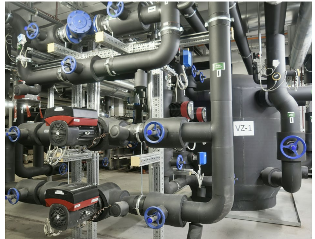
Noua centrală de alimentare cu energie pentru răcire cu unul dintre cele trei distribuitoare Zortström și pompe de răcire
