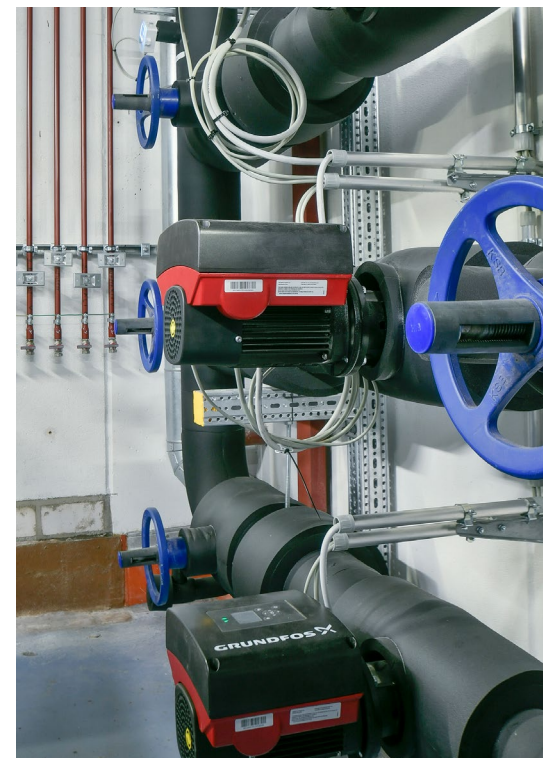
Pompe de apă rece pentru pomparea mediului circulat rece către distribuitorul Zortström
