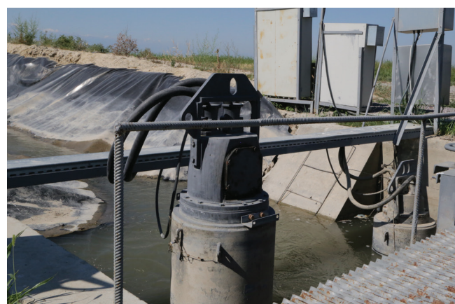
Насосы GRUNDFOS S2 и шкафы управления
