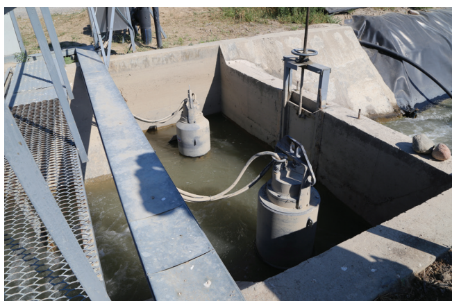
Насосы GRUNDFOS S2 установленные в водоразборном шлюзе
