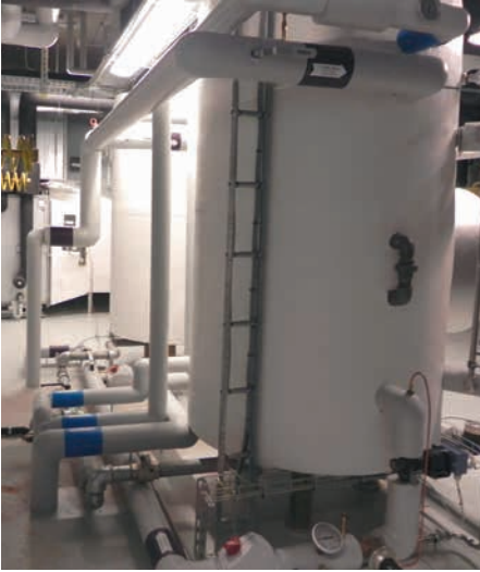
Теплоизолированный бак горячей воды на коммерческом объекте
