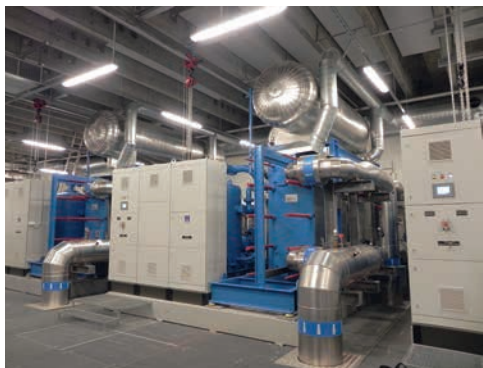
Станция центрального холодоснабжения, обслуживающая несколько коммерческих объектов.
