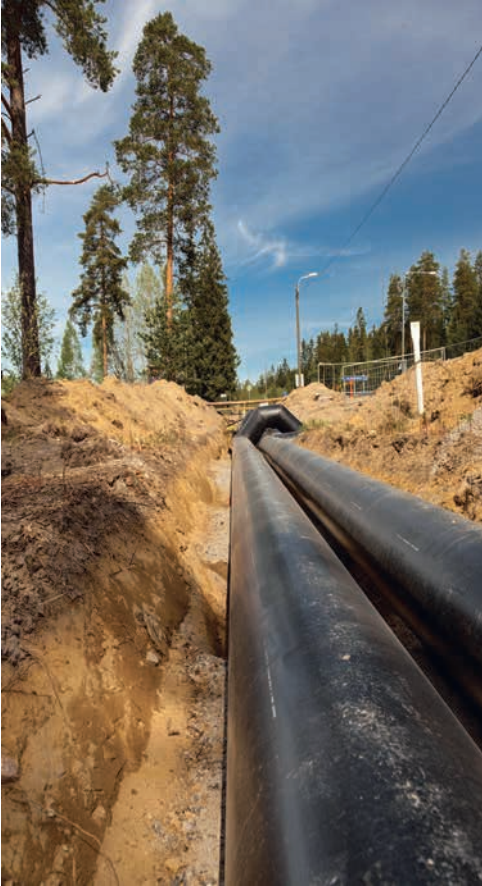
Теплотрасса системы центрального теплоэнергоснабжения
