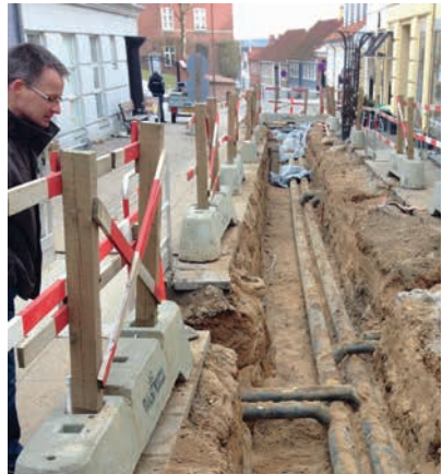
Подземная теплотрасса в центре города.
