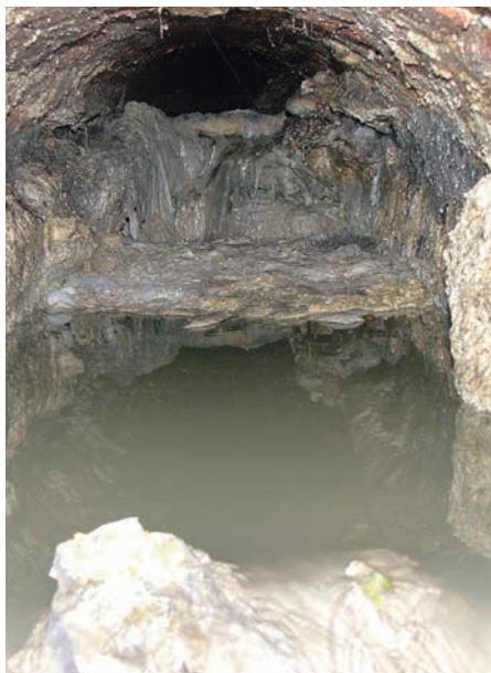
Пример обрастания канализационной трубы большого диаметра жирными остатками и мусором
