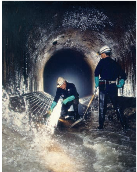
Канализационные коллекторы под улицами Лондона
