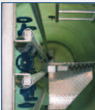
Встроенная лестница для технического обслуживания
