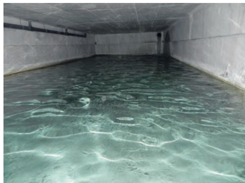
Резервуар, устроенный внутри здания
