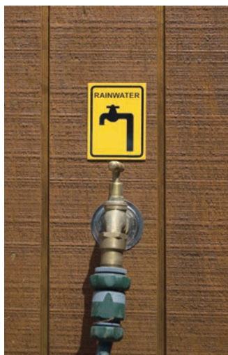
Внешний кран накопительного бака дождевой воды
