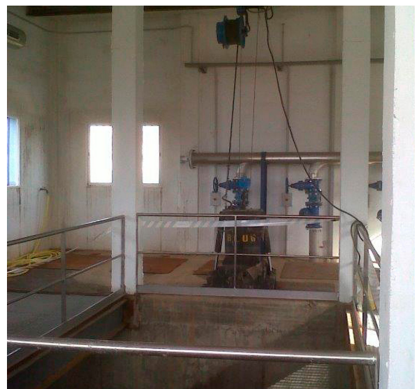
Pogled unutar pumpne stanice.
