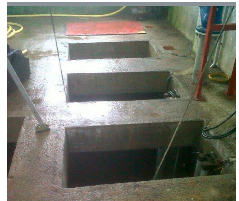
Pumpne jame Pumpe su mokro instalirane.
