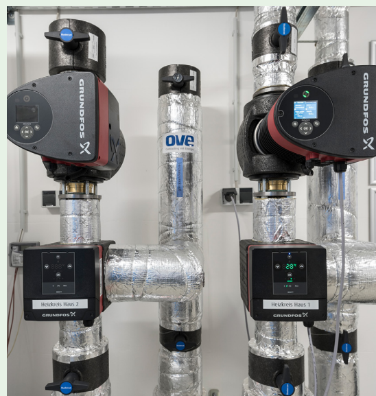
Krug sa mešanjem za fazu izgradnje 1 (desno) i 2 (levo), svaka sa MIXIT kontrolnom jedinicom i pumpom sekundarnog kruga MAGNA3.
