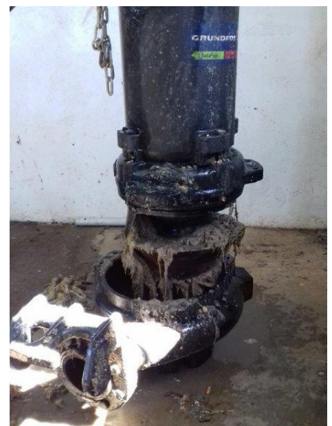
Ett exempel på igensättning av en av de gamla pumparna.
