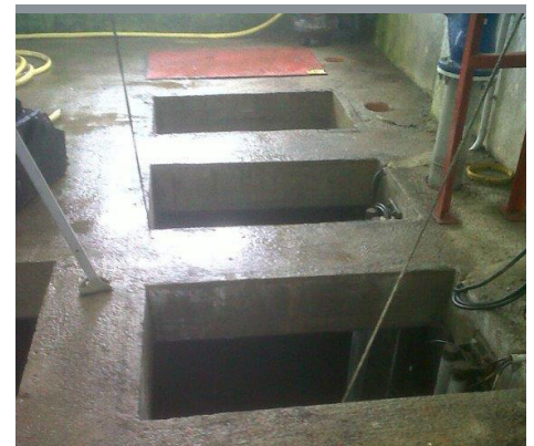
Pumpbrunnarna. Pumparna är våtuppställda.
