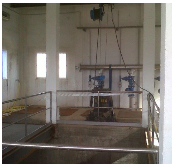
En titt inne i pumpstationen.
