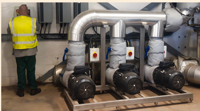
De nya NB-pumparna för kylt vatten
