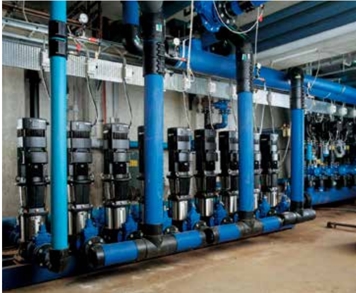
แถวของกรุนด์ฟอส CRE E-pump สำหรับหมุนเวียนน้ำหล่อเย็นในโรงงานเครื่องจักร
