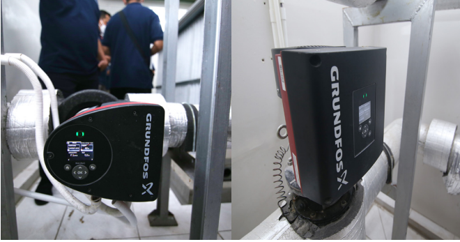
Soldan sağa: Soğutma grubu makine odasındaki MAGNA3 ve TPE pompalar
