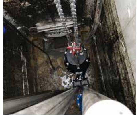
Grundfos 18,5 kW SL pompalar, pompa istasyonunda ıslak alana monte edilir.
